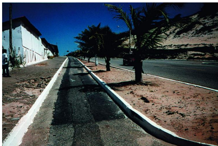
FIGURA 113 CICLOVIA COM PAVIMENTO EM MAU ESTADO, NA VIA COSTEIRA
