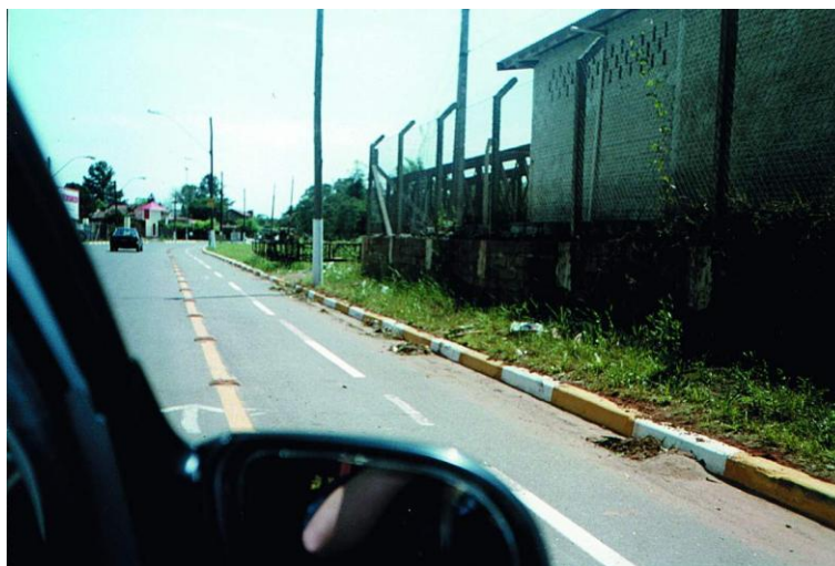
FIGURA 83 DETALHE DA QUANTIDADE DE AREIA ACUMULADA NA CICLOFAIXA
