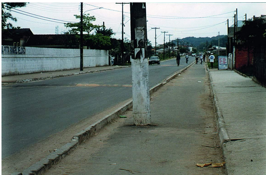
FIGURA 39 POSTE NO MEIO DE VIA CICLÁVEL IMPLANTADA
